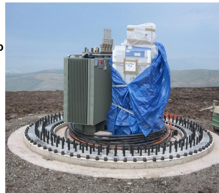
Основа турбины и трансформатор (Фото: Пол Андерсон)
